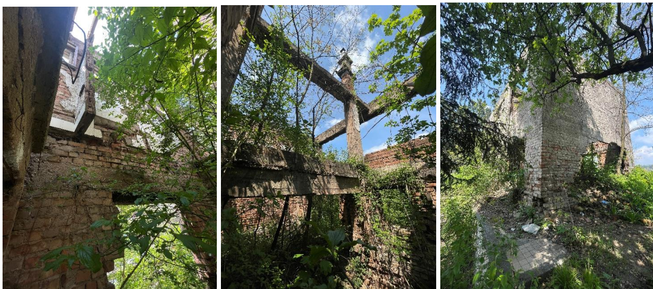
Slika 87 Zatečeno stanje vile Šamanek, unutrašnjost objekta, iz arhive autora: Lejla Kabrović Handžić, maj 2023. godine.
