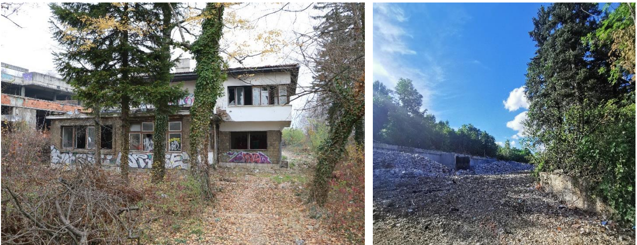
Slika 74 Degradirano stanje vile Crni vrh ratnim razaranjima, iz arhive autora: Lejla Kabrović Handžić, maj 2019. godine. Slika 75 Potpuna destrukcija vile Crni vrh, iz arhive autora: Lejla Kabrović Handžić, juli 2021. godine.
