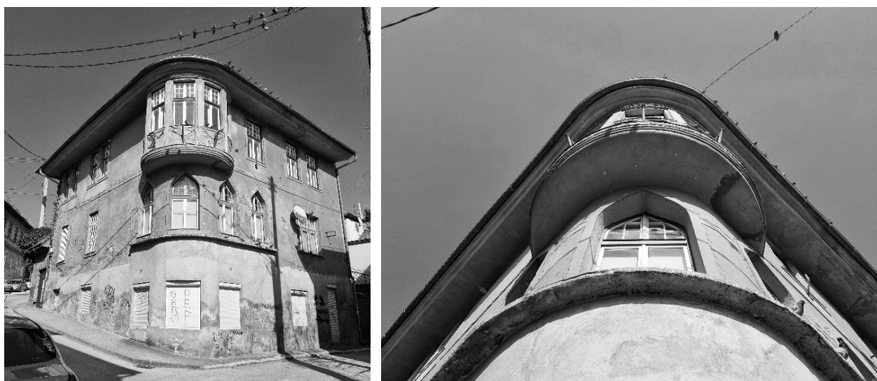
Slika 13 Zatečeno stanje kuće Nurudina Azabagića, J. Pospišil, Sarajevo, iz arhive autora: Lejla Kabrović Handžić, februar 2022. godine.
