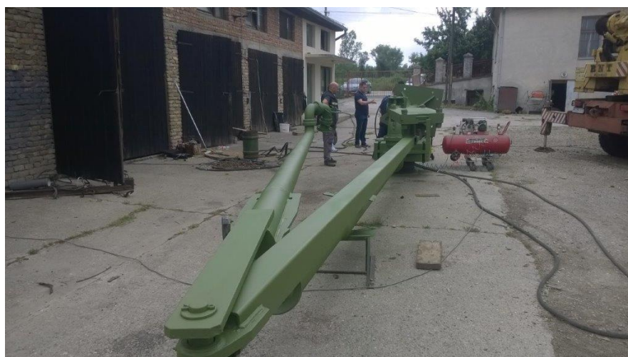
Slika 5. Izvodjenje pasivne zaštite od korozije premazima i ispitivanje na pritisak istovarne ruke
