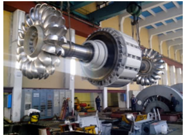
Slika 3.9. Primjer Peltonove turbine na vratilu sa generatorom u HE "Peručica"
