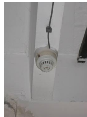
Аутоматски јављач пожара
