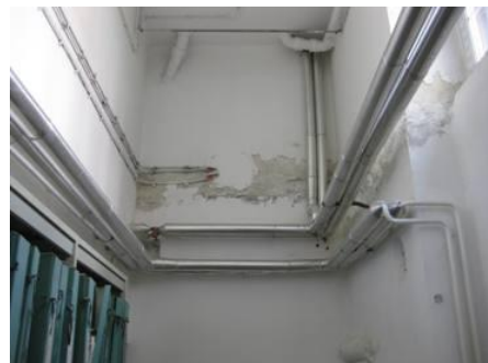
Депо бр.8. Оштећења зида дуж цevi од централног грејања
