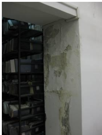
Депо бр.8. Оштећења изазвана капиларном влагом
