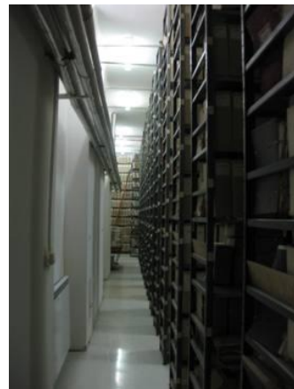
Депо бр.8. Цevi од централног грејања које пролазе кроз депо
