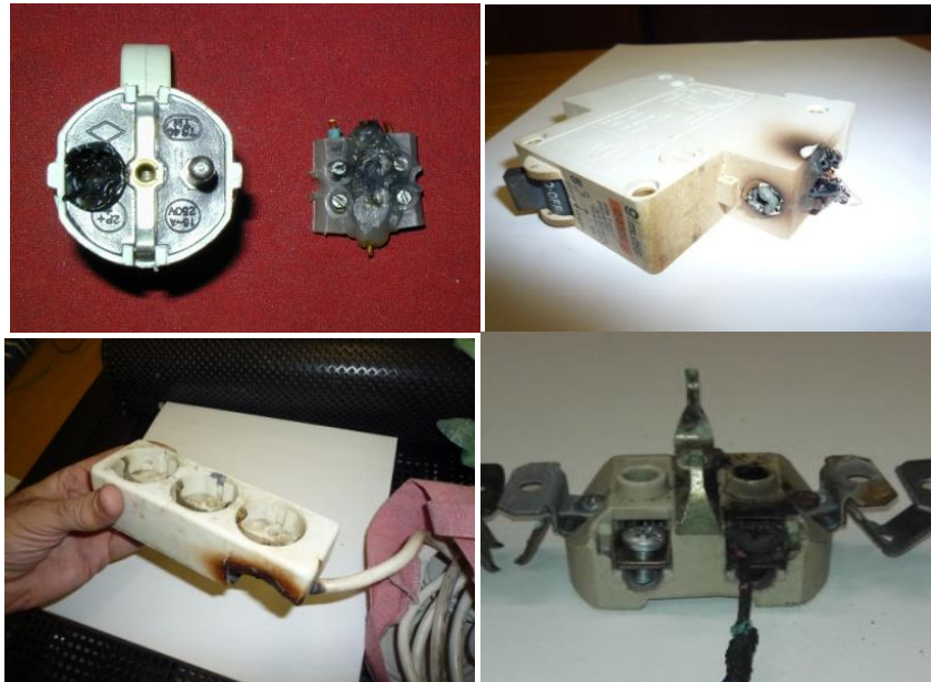
Слика 10. Примери оштећених електроинсталационих компоненти услед лошег електричног контакта [25]
