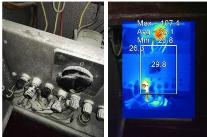
Слика 13. „Врела“ тачка на једној од стезаљки фазног проводника
