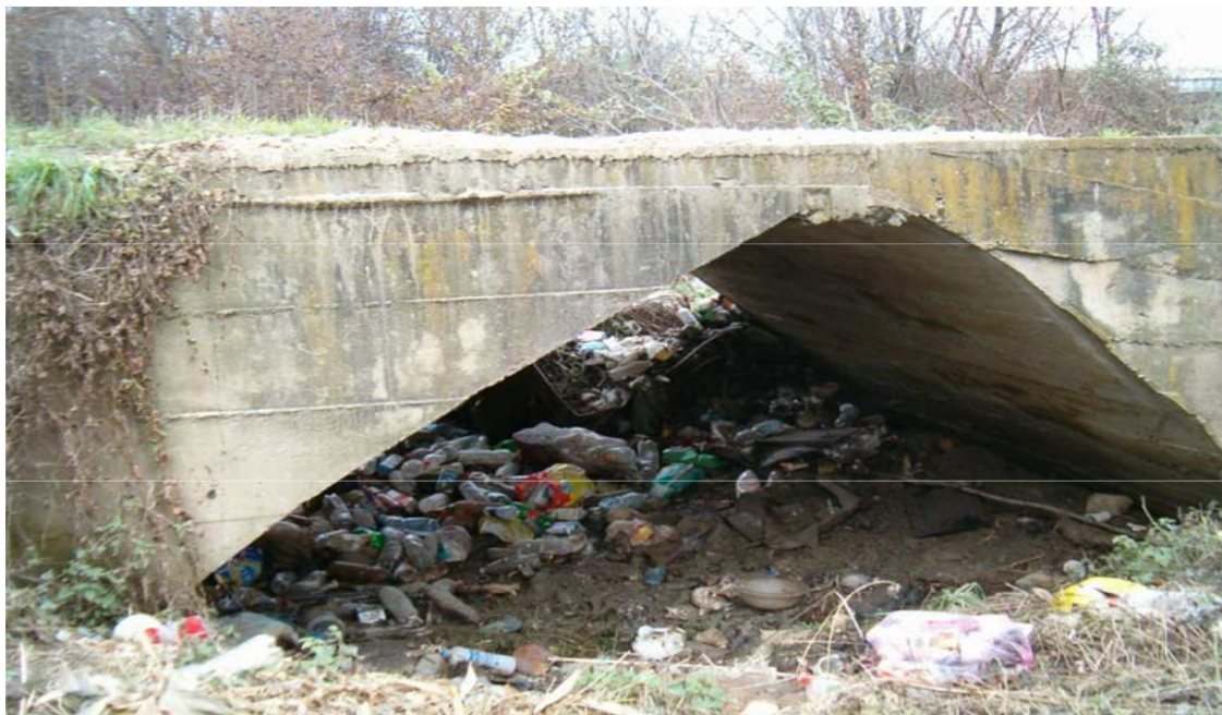
Слика 4. Затрпан пропуст испод моста
