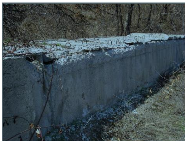
Slika 58. Oštećeni deo kanala za gravitacijski transport pulpe
