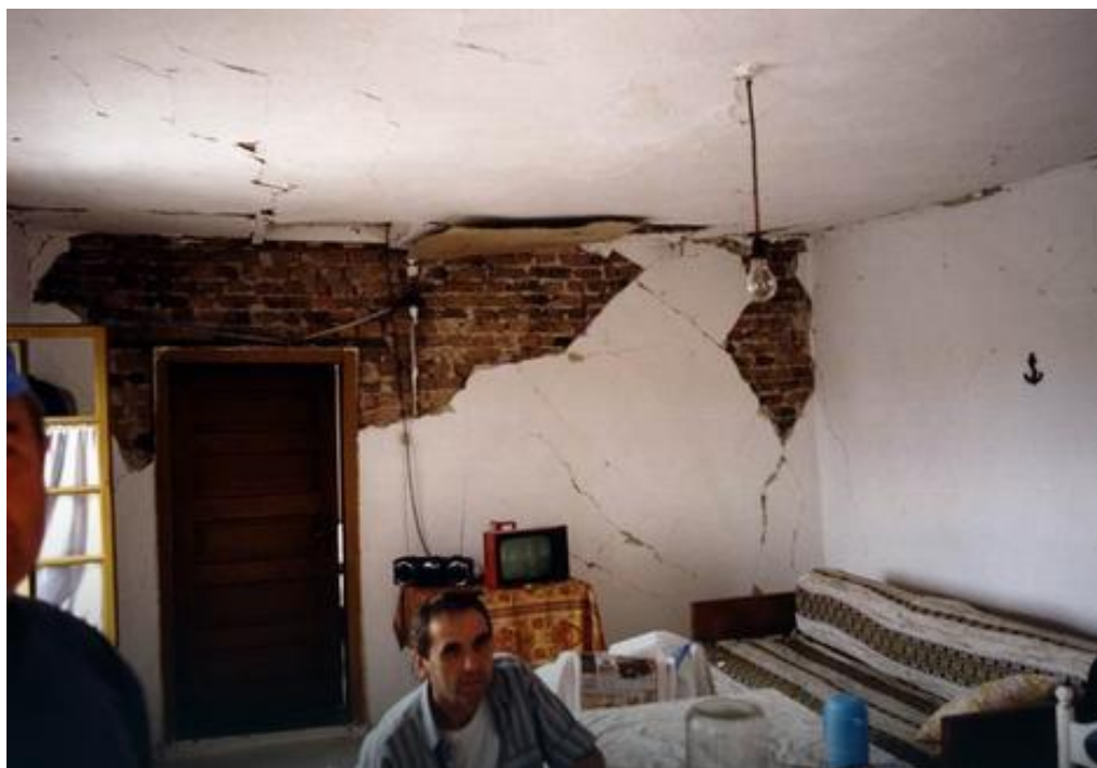
Слика 9 - Оштећења унутар једног стамбеног објекта у Мионици 1998., извор: http://www.blic.rs/vesti/srbija/mionica-bez-obnove-2000-kuca-ostecenih-u-zemljotresu/ve3v5ht , 25.05.2017.
