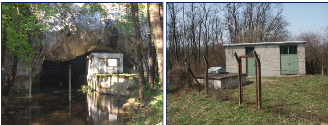
Slika 2.4. Ograđivanje neposredne zone zaštite na primeru karstnog vrela Gaura Mare - Zlotska izvorišta u Istočnoj Srbiji
