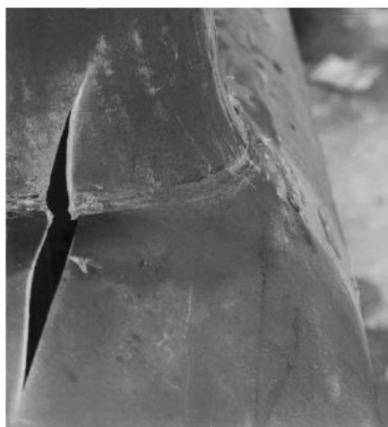
Slika 1.19. Prikaz pukotine nastale na spoju dva cilindra [33]
