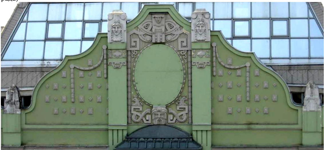
Слика 9б. Детаљ фасаде (Извор: Јањушевић, Богдан. Настанак и развој стамбених палата и вила у Војводини обликованих у стилу сецесије крајем XIX и почетком XX века (докторска дисертација). Београд: Архитектонски факултет Универзитета у Београду, 2013, стр. 215).
