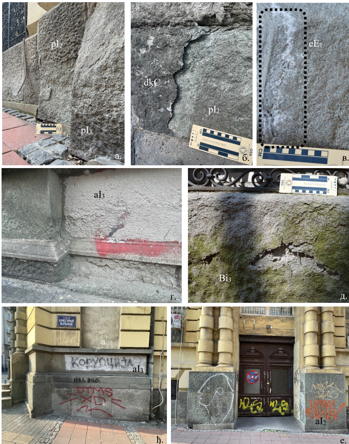
Слика 71. Форме распадања друге групе оштећења – деколорација/наслаге на споменику културе Згради класне лутрије; а) запрљаност услед наслага нечистоћа из атмосфере; б) црне коре ; в) исољавање ; г) запрљаност услед антропогеног утицаја-фарбање површине камена; д) биолошка колонизација нижим биљкама; ђ-е) запрљаност услед антропогеног утицаја-вандализмом - истисивањем графита
