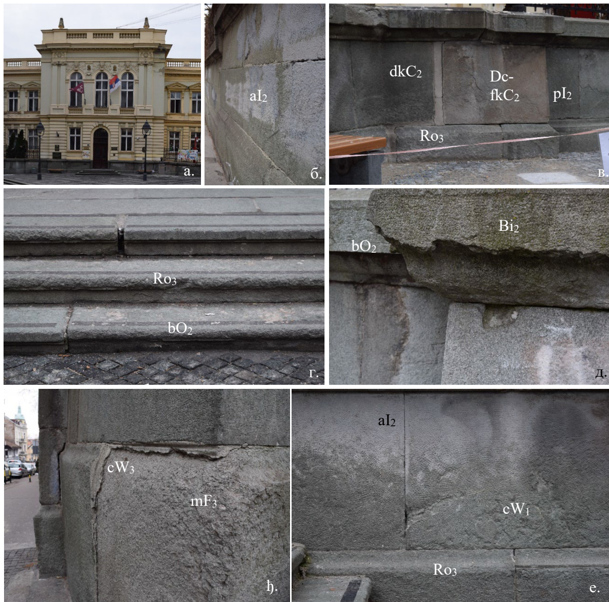
Слика 80. ОШ „Краљ Петар I“: а) општи изглед; б) запрљаност изазвана антропогеним утицајем; в) форме деградације на оградном зиду; г) заобљавање и комадасто распадање на степеништу; д) комадасто распадање ивичних профила; е) дубинско распадање и љуспање; ж) заобљавање, запрљаност и дубинско распадање на оградном зиду
