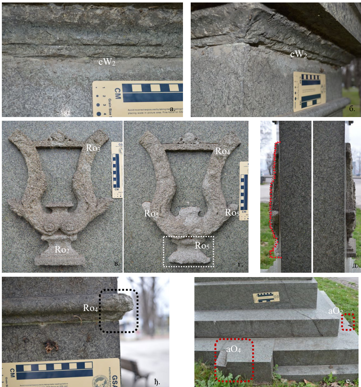
Слика 56. Форме распадања прве групе оштећења – губитак каменог материјала на споменику Ђури Јакишићу; а) дубинско распадање на северној страни споменика; б) дубинско распадање на источној страни споменика; в) рељефно распадање лире на северној страни споменика; г) рељефно распадање лире на северној страни споменика; д) упоредни приказ рељефа лира у профилу; њ) рељефно распадање - заобљавање угаоног дела
