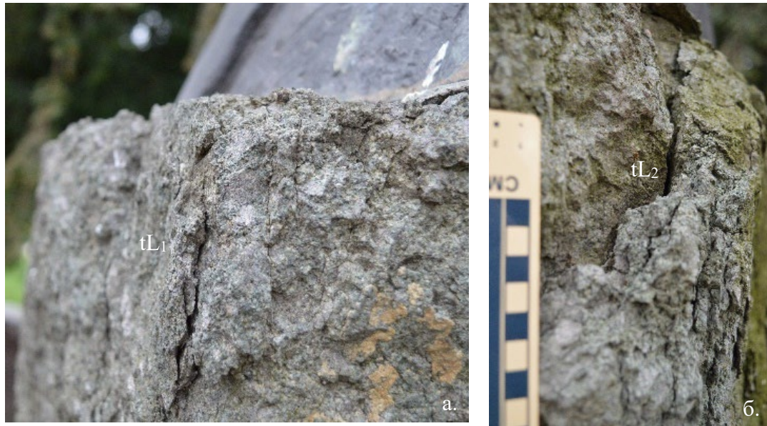
Слика 65. Четврта група распадања -пукотине а) детаљ пукотина на западној страни споменика; б) детаљ пукотина на источној страни споменика
