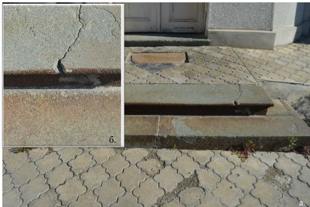
Слика 79. Пукотине: а) пукотина на степенику; б) увеличан детаљ
