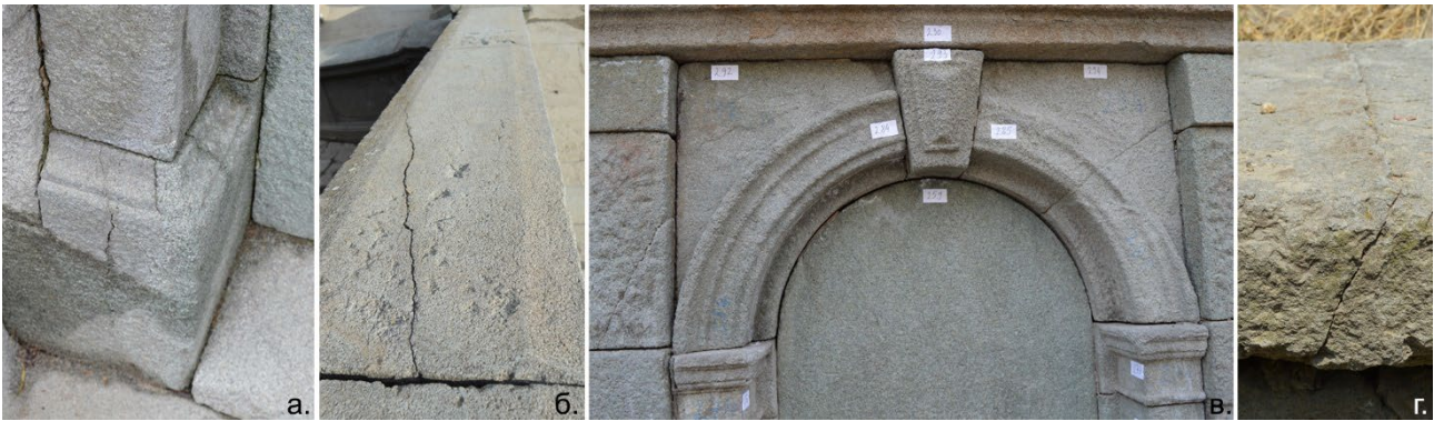
Слика 50. Четврта група оштећења-пукотине: а) мрежа пукотина на бази корита; б) пукотина на рукохвату; в) дијагонална пукотина на блоку у централном фронту са чесмом; г) пукотина целог блока покривне капе
