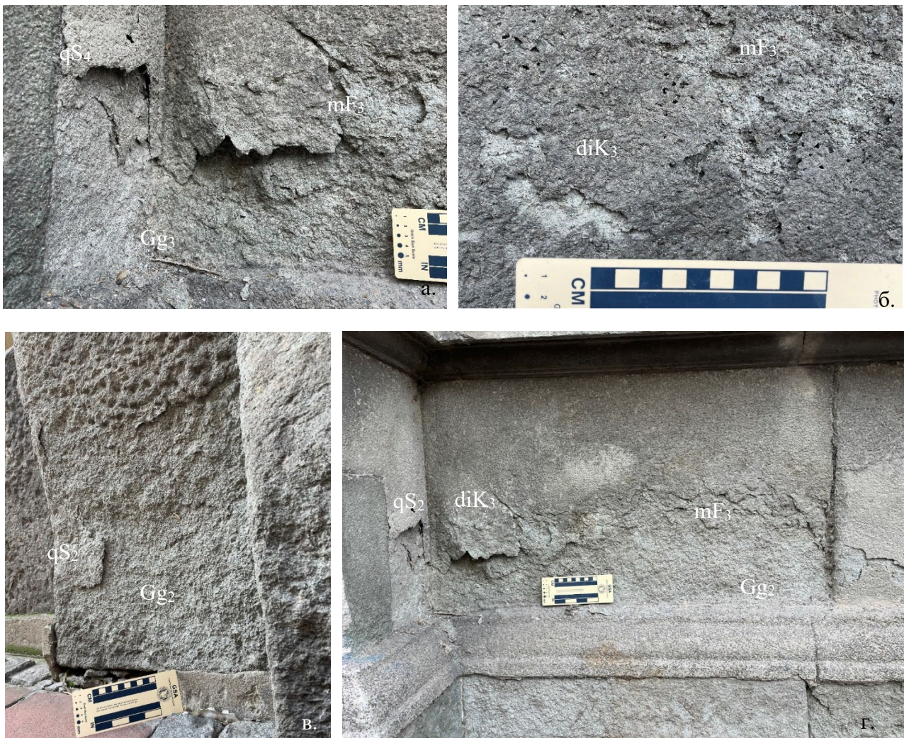
Слика 72. Форме распадања треће групе оштећења – одвајање: а) љускање и љуспање; б) одвајање тамне коре, зрнаста дезинтеграција и губитак минералних конституената и последично заостале шупљине; в) љускање и зрнаста дезинтеграција; г) пример блока на којем постоји љускање, љуспање, одвајање тамне коре и зрнаста дезинтеграција
