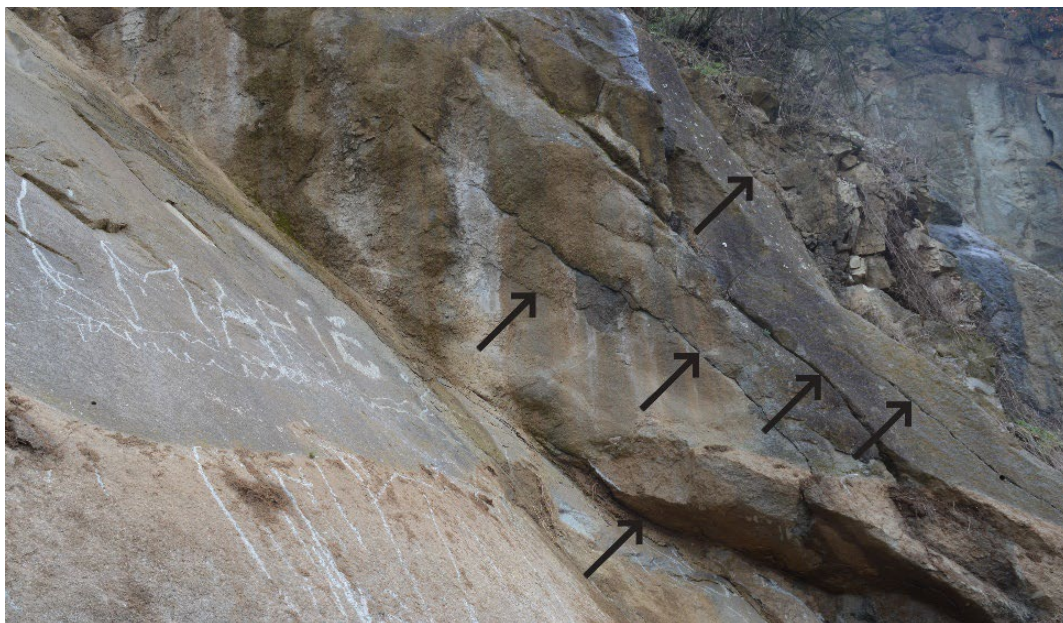
Слика 33. Паралелне пукотине које доводе до одвајања стенске масе
