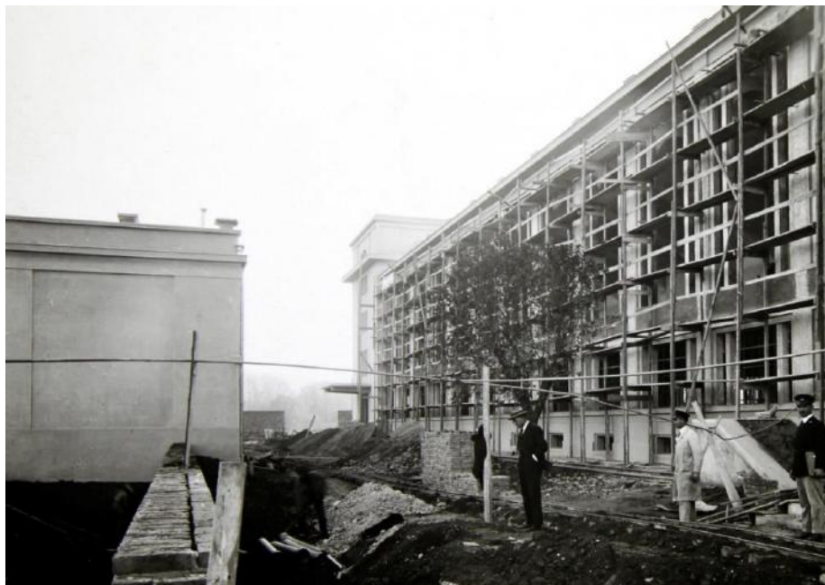
Сл. 45 Јосиф Најман, Завод за израду новчаница, изградња погонске зграде (извор: АНБС, кутија 19)
