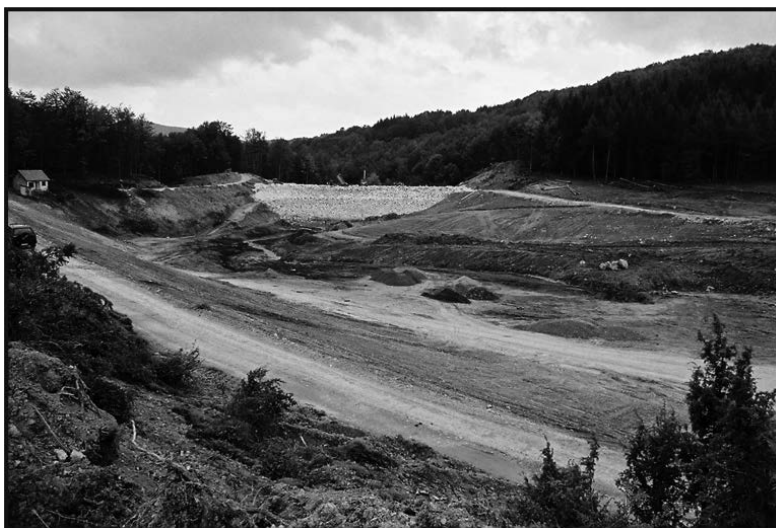
Слика 4. Брана и акумулација „Селиште“ завршна фаза изградње Figure 4. The final construction phase of Seliste Reservoir and Dam
