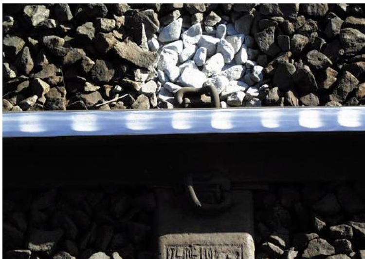
Слика 3.14 Дефекат 2201 и изазвано оштећење застора у зони нарушеног ослањања прага [13]
