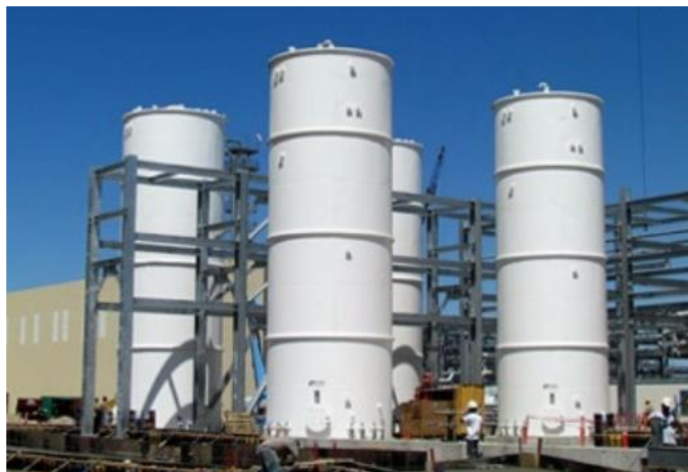
Slika 1 Vertikalni cilindrični skladišni rezervoar
