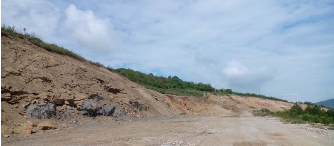
Slika 6.8 Izgled kosine Gradinje km 99+820 do km 100+660 (14.08.2012.)
